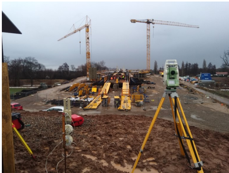
Obr 6 – umístění sledovací totální stanice a vysílače lokální datové sítě
